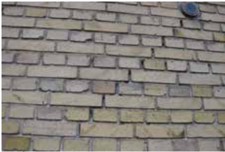
Skrå revne i murværket.
