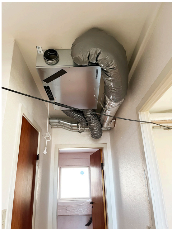
Ventilationsanlæg i entréen.
