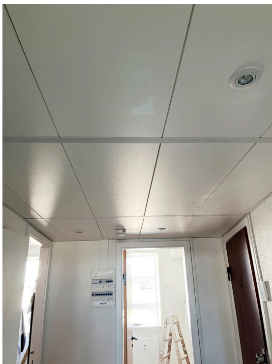
Nedsænket loft, der skjuler ventilationsanlægget.
